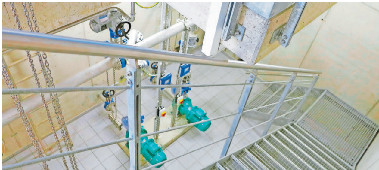
Blick von oben in das neue Pumpwerk in Ostheim. Es kann an diesem Sonntag von 14 bis 17 Uhr besichtigt werden, inklusive Überlaufbecken. In Hüssingen waren genau diese technischen Einrichtungen ebenfalls erforderlich.
